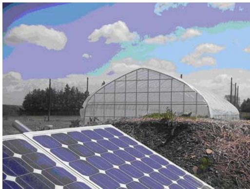
太陽光パネル設備
